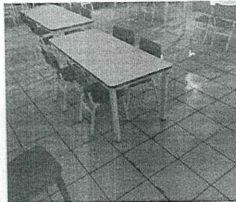
Acúmulo de água Manoel Moraes.
