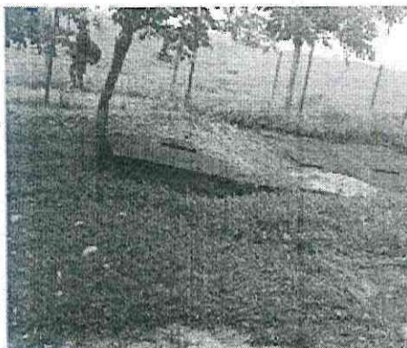
Fossa Septica Elisio da Costa Moreira.
