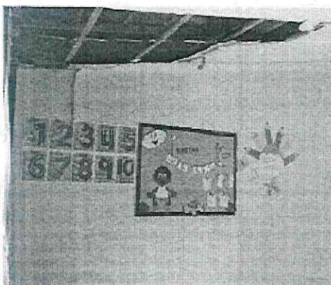
Forro Drywall danificado EMESPP.
