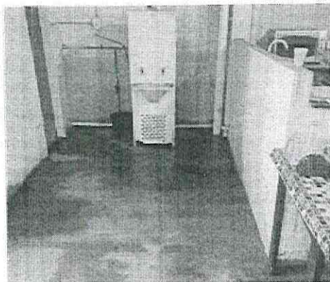
Poças de água causado pela chuva Almoxarifado.
