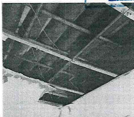
Forro Drywall danificado EMESPP.
